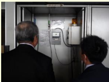
廃油タンク警報装置 < レクサス宮城野 >
