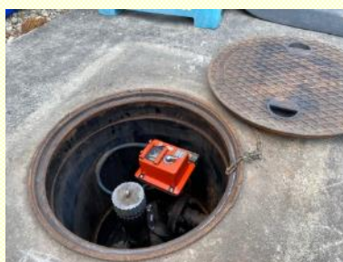
廃油地下タンク 廃油保管量を適正に管理 法定点検を定期的実施
