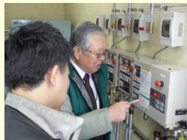
重要設備の監視計器類 < 泉インター店 >
