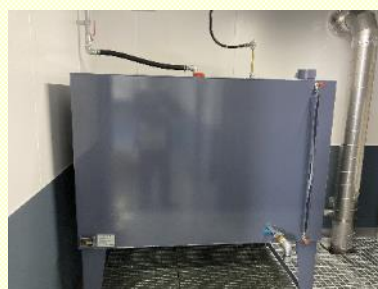
廃油地上タンク 廃油保管量を適正に管理 防油堤を設置
