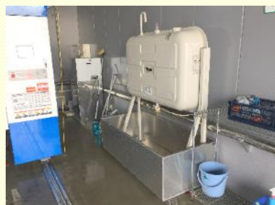
灯油タンク 送油配管からの油漏れ 防油堤の水抜栓の確認
