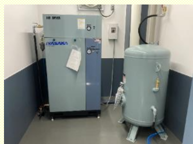
エアコンプレッサー 専用室に設置 防振・防音対策済
