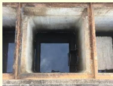
油水分離槽 毎週点検により汚水状態の管理 定期水質調査・定期洗浄の実施
