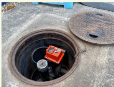
廃油地下タンク 廃油保管量の適正管理 法定点検により管理
