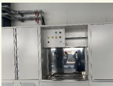
オイル圧送設備 配管・バルブの点検
