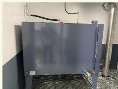
廃油地上タンク 廃油保管量の適正管理 防油堤を設置
